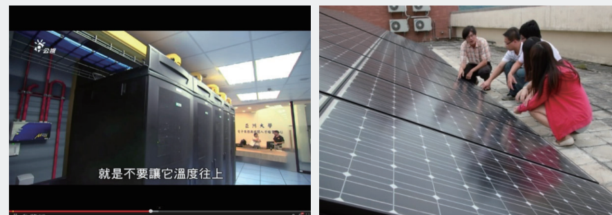
圖5-6 高效冷熱分流之綠能雲端資訊主機房及太陽光電發電系統
